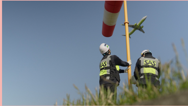
제주국제공항 항공등화팀 풍향등 점검 작업
